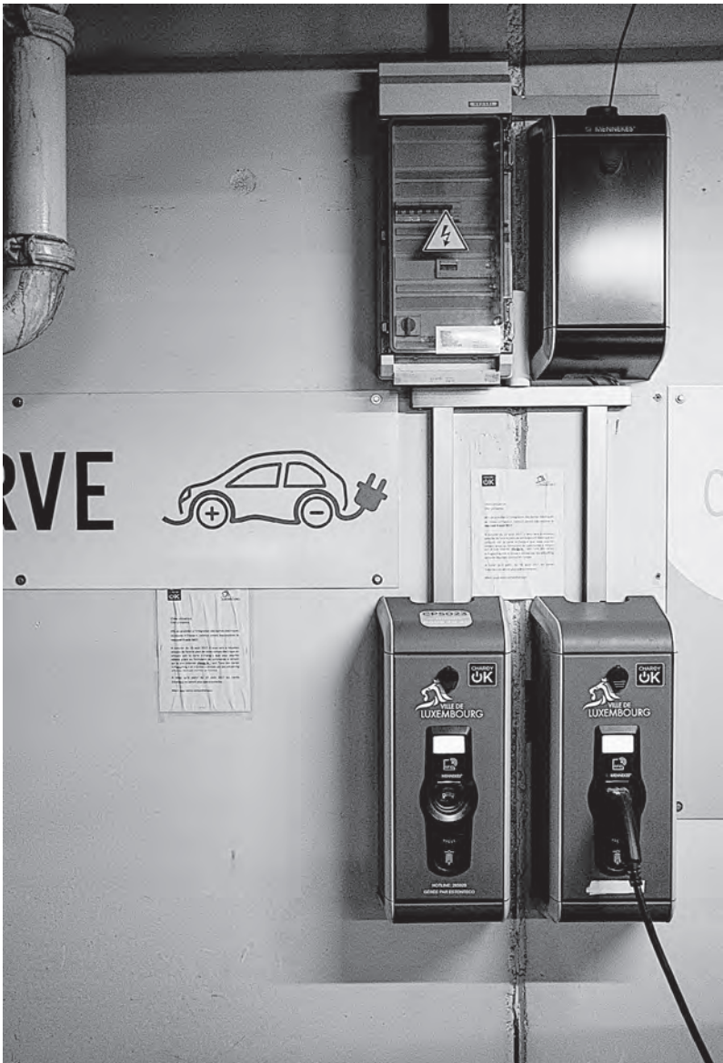
Ladeeinrichtung für Elektroautos in einer Tiefgarage in Luxemburg-Stadt
