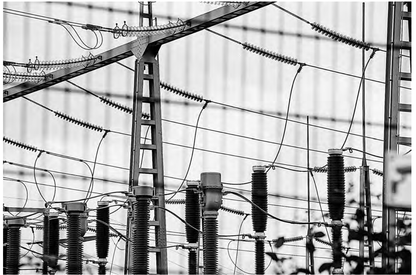
Umspannungswerk in Roost: Sogar wenn die Haushalte weniger verbrauchen und ihren Strom selbst produzieren, müssen weitere Transportleitungen gebaut werden
