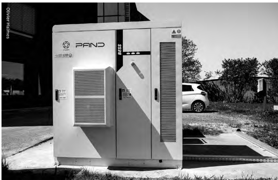
Eine der drei Batterien des Luxembourg Institute of Technology
