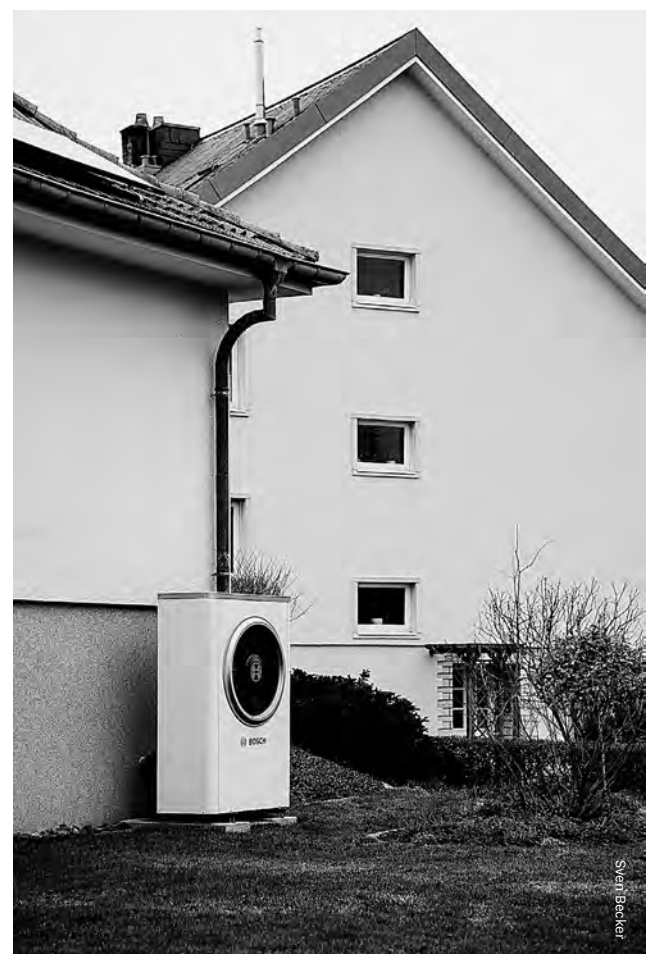
Teil einer elektrisch betriebenen Wärmepumpe
