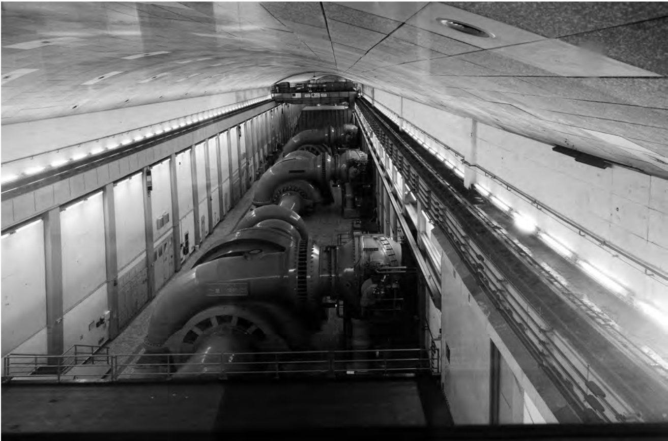
Blick in die Turbinenhalle. Die Turbinenleistung liegt bei insgesamt fast 1 300 Megawatt
