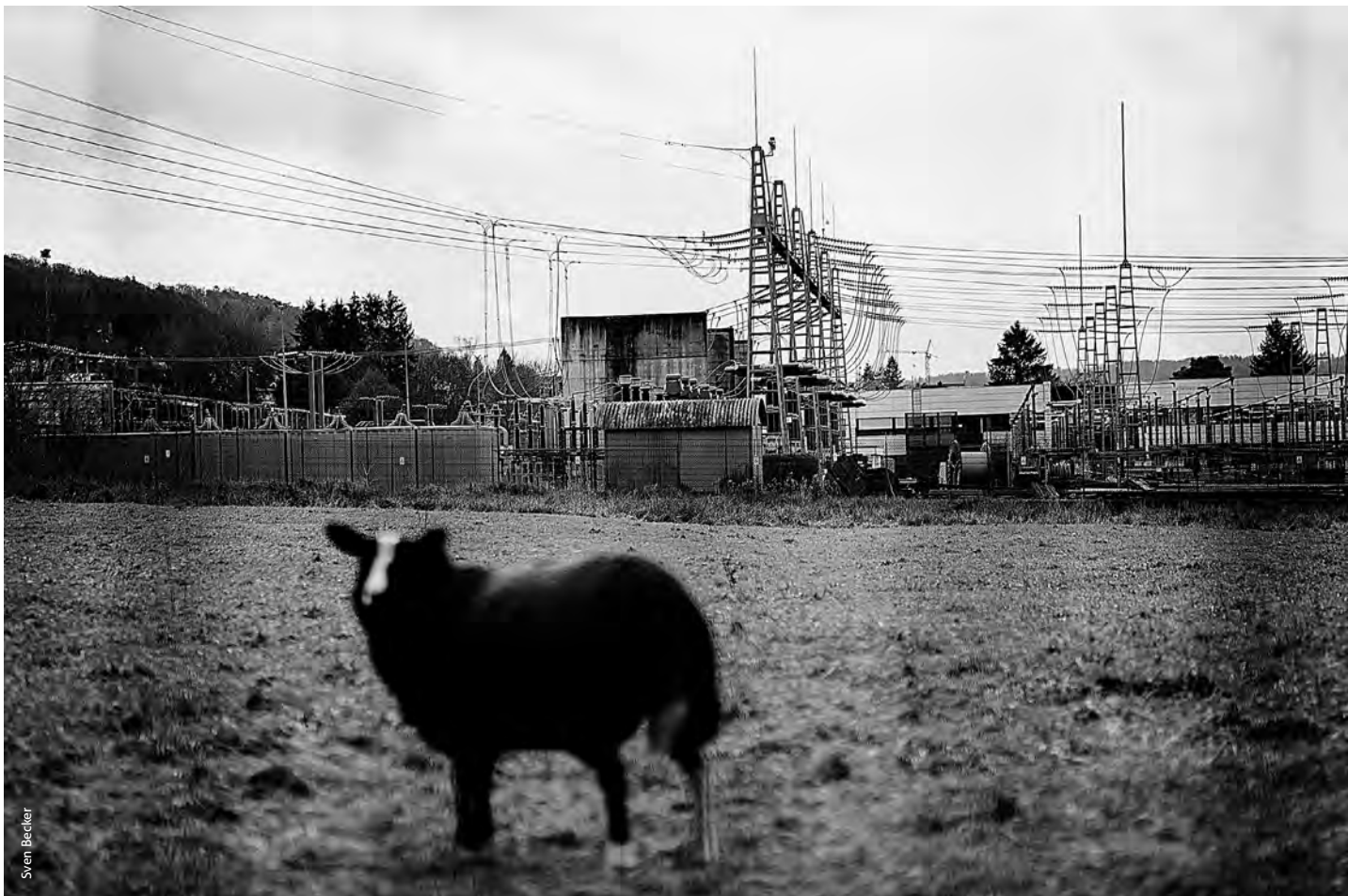
Umspannwerk von Creos in Heisdorf
