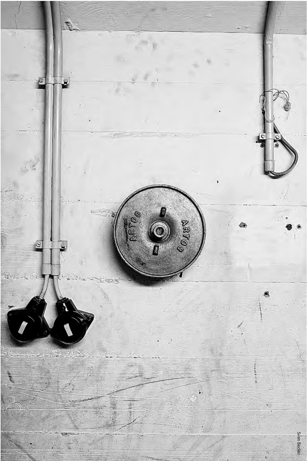
Der Bunker in der ehemaligen Stater Feuerwehr- Kaserne besitzt als einziger eine Luftfilteranlage
