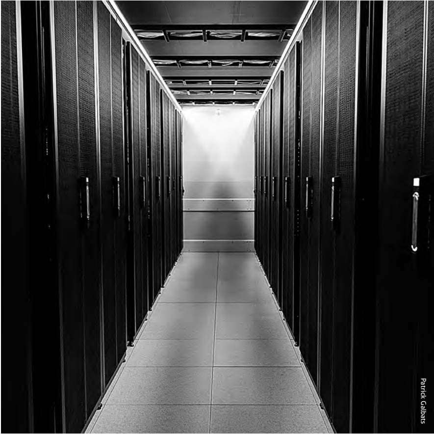
Serverfarmen benötigen neben viel Strom auch viel Kühlwasser
