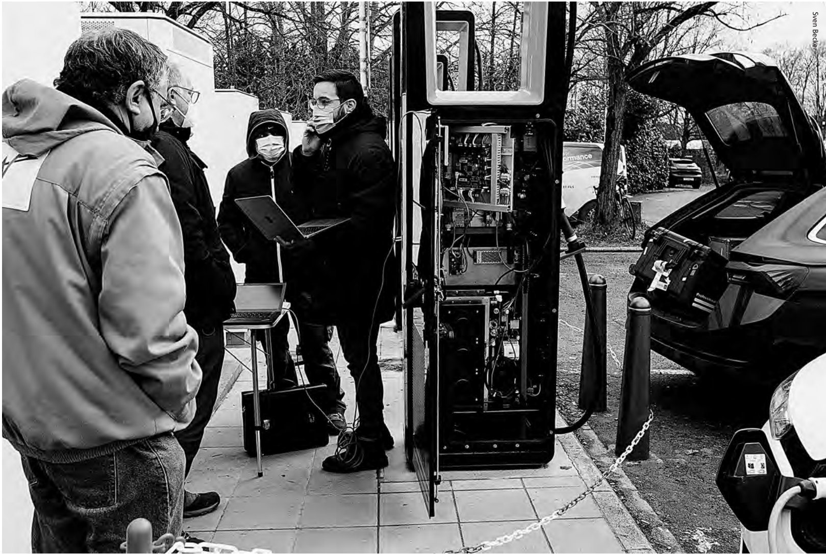
Aufbau von Schnellladesäulen auf dem Uni-Campus Kirchberg dieser Tage
